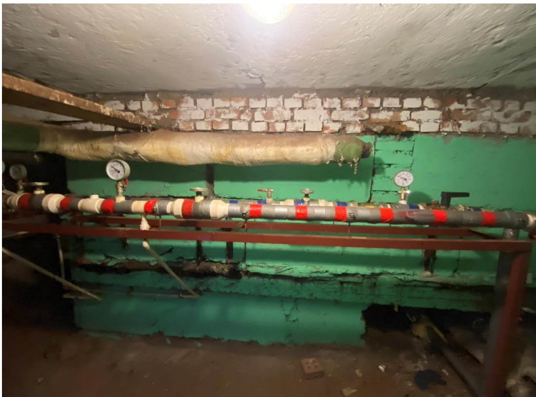
Рис.2. ИТП (подача ГВС.)
